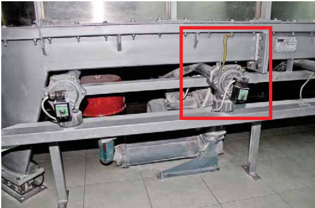
Fot. 9. Uziemienie instalacji pneumatycznej w magazynie mąki, w celu zapobiegania możliwości wystąpienia wybuchu.
