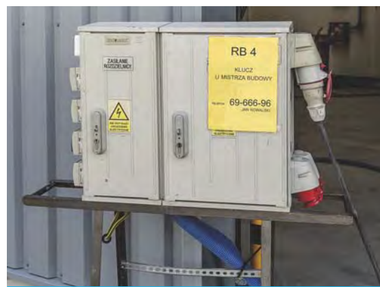
Rozdzielnica zabezpieczona przed dostępem osób nieuprawnionych.
